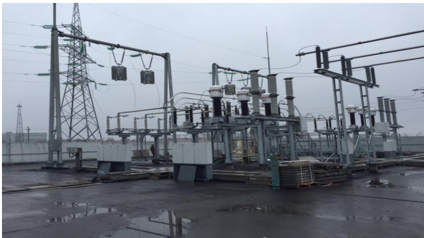
Объект электроснабжения для ОАО «Тамбовская индейка»
