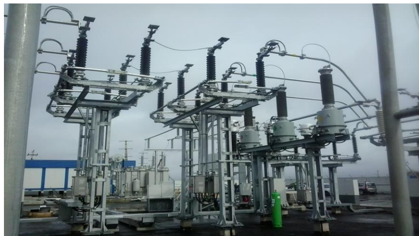
ПС Фабричная 110/10 кВ для энергоснабжения АПК ООО «Токаревская птицефабрика»
